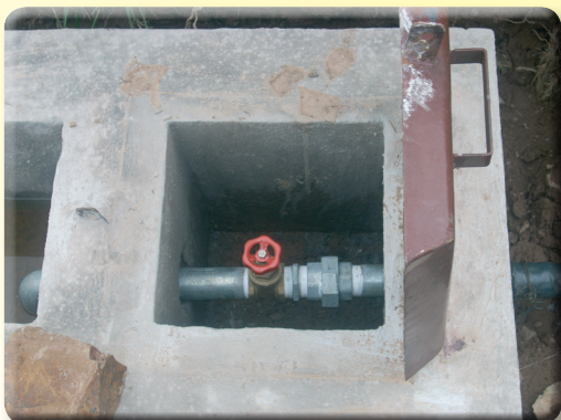
Ω Cámara de llaves para distribución del agua
